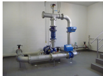
Hydraulische Anlage mit ferngesteuerten Pumpen, Schiebern und Klappen
