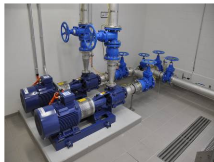
Quellwasserpumpen im Werk Haslach
