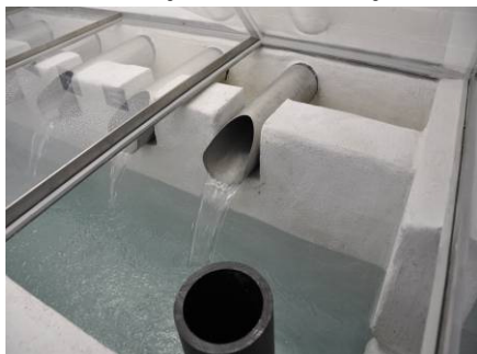
Sammelbrunnstube im Quellwasserpumpwerk
